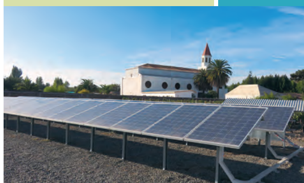
SISTEMA FV SOBRE SUELO
