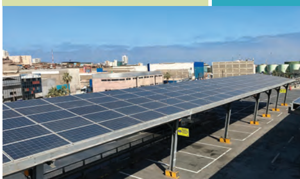
SISTEMA FV EN ESTACIONAMIENTO
